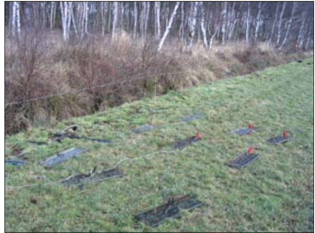
Abb. 7: Erdungsfeld bei einer Einspeisung im Messgebiet bei Cuxhaven. Zur Erdung wurde hier eine große Anzahl von Stahlblechen verwendet, die durch Kabel miteinander verbunden waren.
